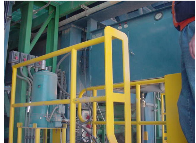
Crusher #2 Lubrication Tank. Minera El Tesoro (Chile)
